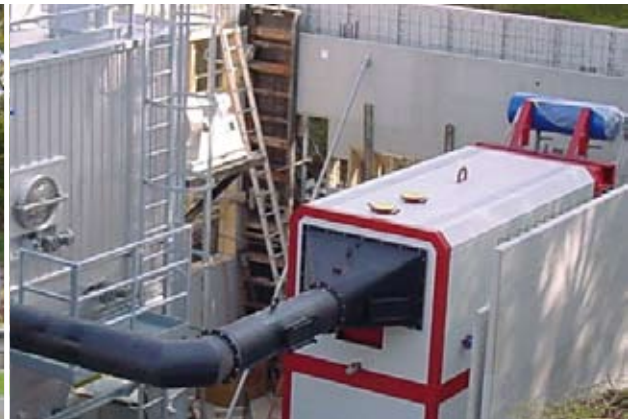
Tübingen, Elektrofilter u. Holzessel
