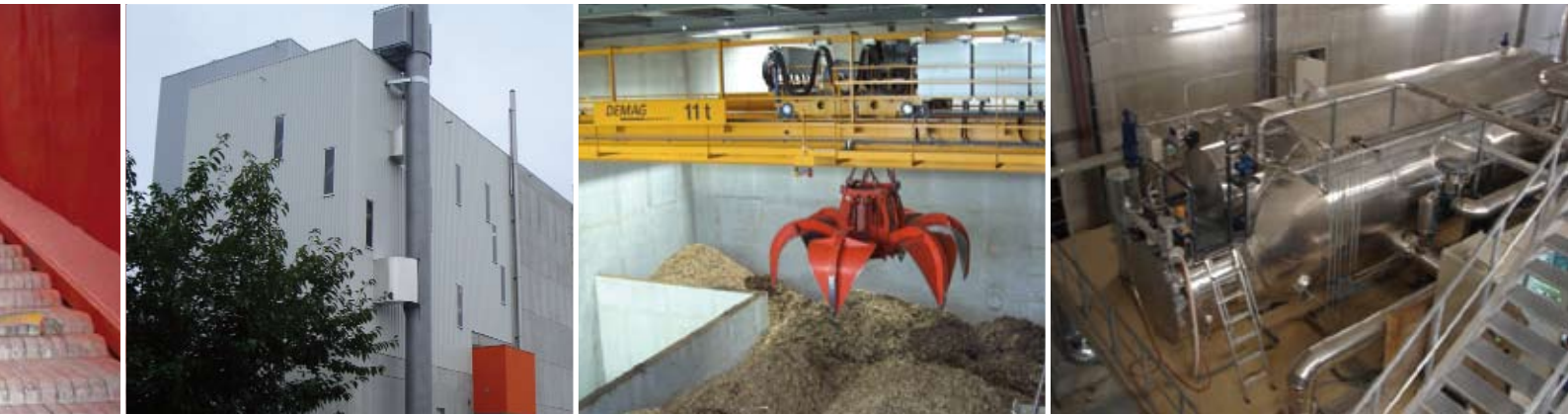
Holzheizkraftwerk Hamburg Lohbrügge
