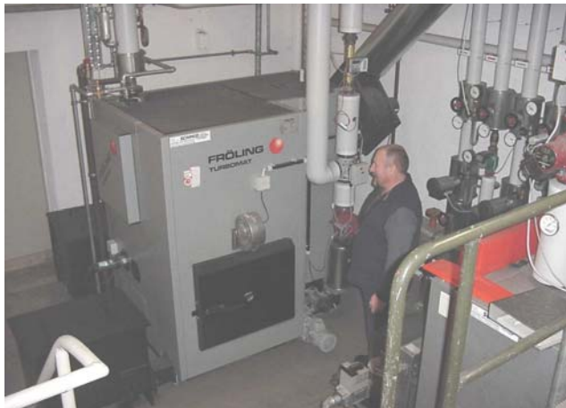
Abbildung 3: Blick in den Heizraum
